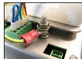
11) Connect MEC oxygen sensor earth to earth stud
