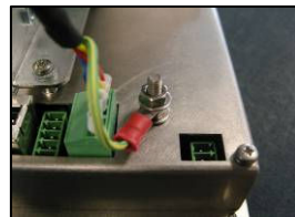
7) Connect MEC oxygen sensor earth to earth stud
